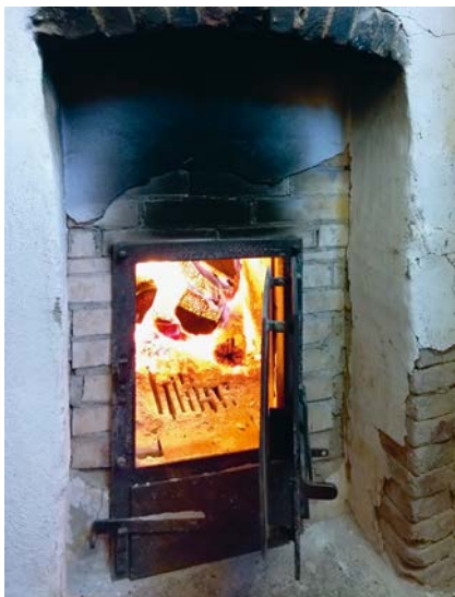
Abb. 2: Befuerungsofen der Kanalheizung am Langen Haus, Schloss Belvedere, Weimar, 2025
